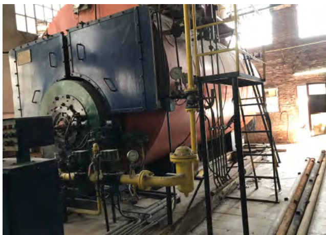
Ilustración 14: Sector calderas. Fotografía propia.
