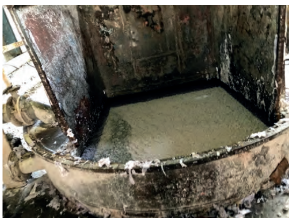
Imagen 8: Pulper vacío donde se cargan insumos para papel higiénico. Fotografía propia.
