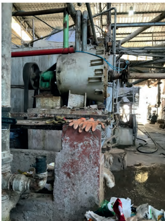
Imagen 10: Ingreso a las tuberías para la pasta de papel Kraft. Fotografía propia.
