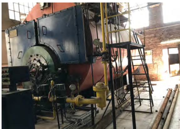
Imagen 18: Sector calderas. Fotografía propia.
